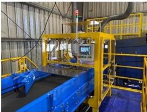
ロボット選別システム全景
